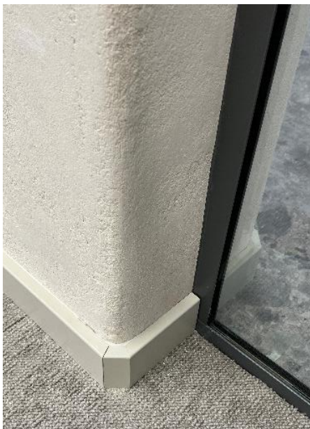
Figur 40. Detalj vägg mot golv. Lagad skada precis ovanför golvlister.
